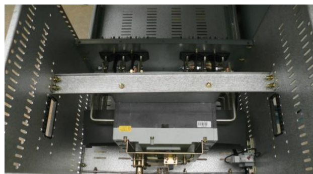
出线 9 抽屉照片
