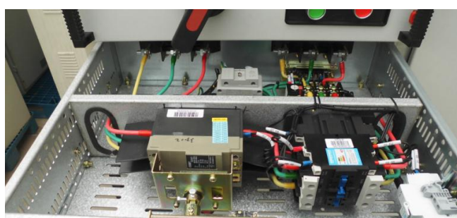
出线 6 抽屉照片
