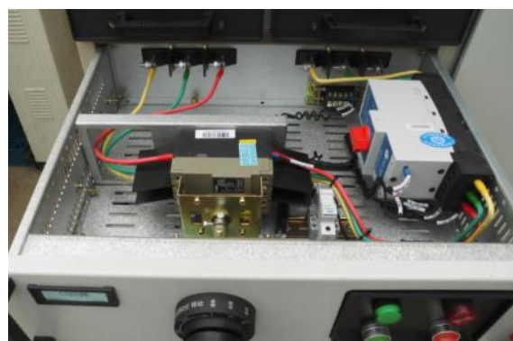
出线 5 抽屉照片
