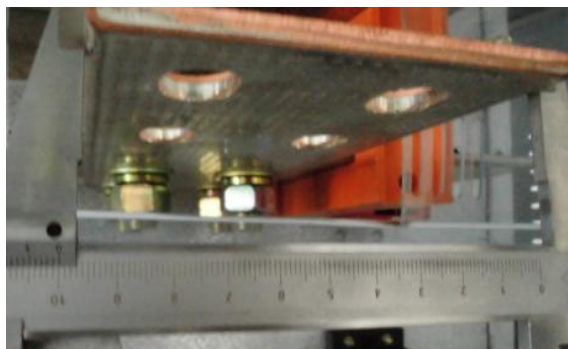
配电母排宽度照片
