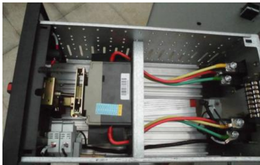
出线 1 抽屉照片
