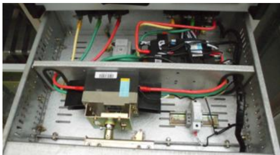
出线 6 抽屉照片
