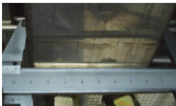
主母排宽度照片
